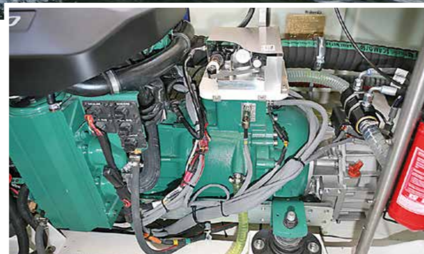
Elmotorn i mitten har samma gröna färg som dieselmotorn till vänster. Till höger sitter motorns ordinarie backslag i grått. Hela konverteringen är mycket elegant utförd.
